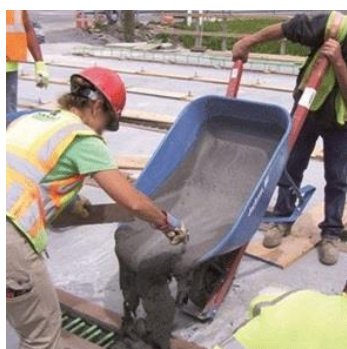
יציקת בטון ממריצה. המקור: Federal Highway Administration. Construction of Field-Cast Ultra-High Performance Concrete Connections.
