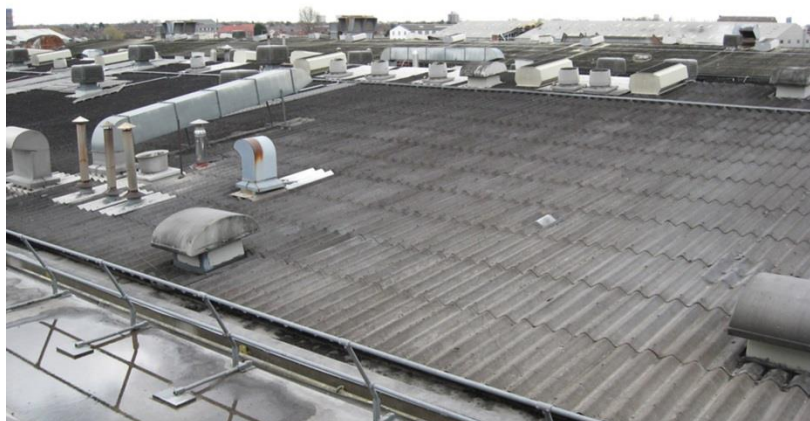
גג שביר. המקור: High Access Solution. https://www.highaccesssolutions.co.uk/fragile-roofing-faq
