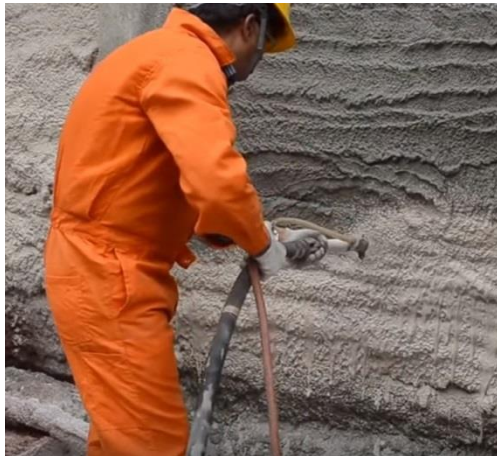
התזת טיח באמצעות מכונת התזה. מקור התמונה: Frigmaires. Wall Plaster Spraying Machine. YouTube. 2 Dec. 2014.
