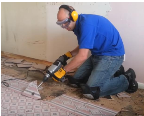
הורדת אריחים ישנים מרצפה. מקור התמונה: Biggles. Titan SDS with a 80mm cranked tile chisel removing a kitchen floor.
