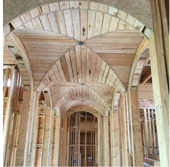
מסגרת עץ להתקנת לוחות גבס. מקור התמונה: TN Precision Painters.com. Drywall Framing & Installation. http://www.tnprecisionpainters.com/
