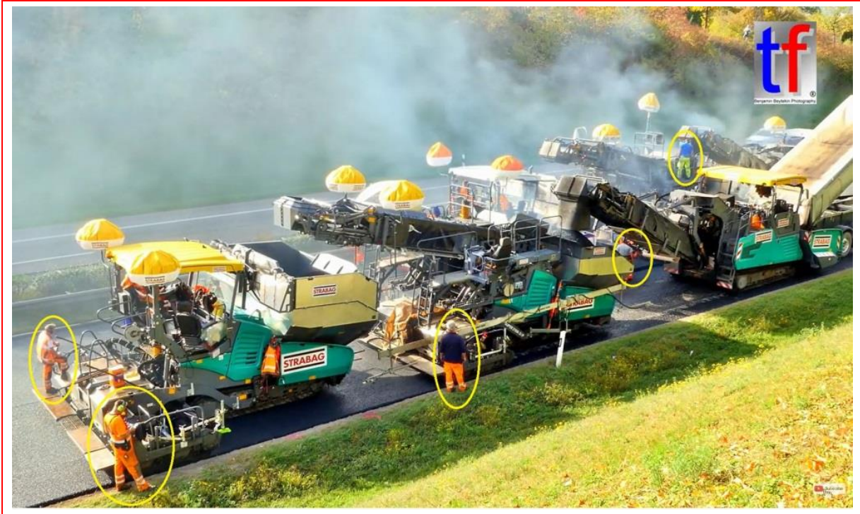
מקור התמונה: Benjamin Beytekin. 2x VÖGELE InLine Pave Einbauzüge, B 14, Stuttgart - Fellbach, Germany, 21.10.2017. YouTube January 2018. https://www.youtube.com/
